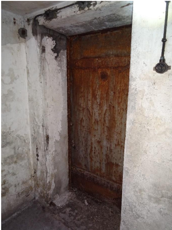
Der südliche Zugang ist versperrt.
