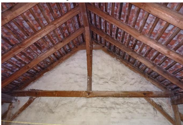
Taubendreck-Reste am Querbalken an der Wand.
