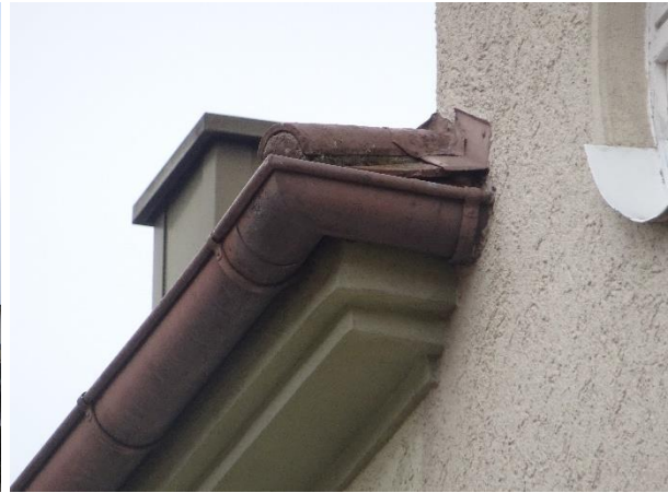
Einzige Lücke im Dachüberstand an den Treppenhaus-Gaube oberhalb der Dachrinne; zu klein für Vögel bzw. zu offen für Fledermäuse.
