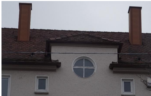
Die Kamine sind verblecht und ohne geeignete Lücken oder Spalten.
