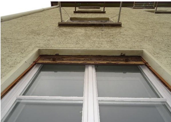
Im Erdgeschoß gibt es Jalousien, der Spalt zwischen Lamellen und Mauer ist aber nur wenige mm breit.
