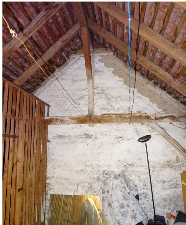
Keine Fledermäuse, aber Wasserschäden auf dem Holz.
