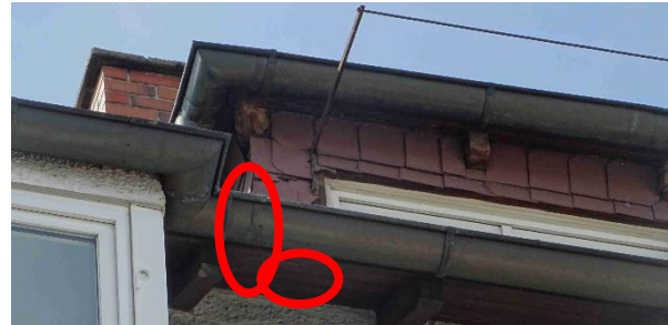
Dachgaube der Nordseite mit diversen Lücken in der Verkleidung (markiert); Ostteil, ...
